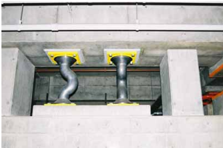
写真6.3 鉛ダンパーの設置状況
